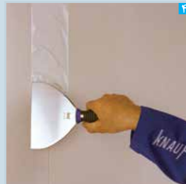
اجرای لایه بتونه در محل درز (کاردک در جهت عمود بر درز کشیده می شود تا بتونه کاملا در درز نفوذ کند)
